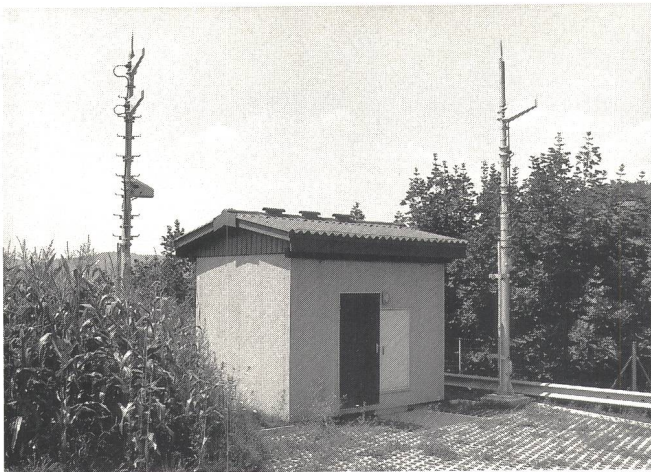
Fig. 5 Gut integrierte Kabine direkt neben der Autobahn
