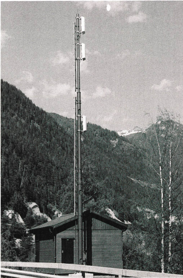
Fig. 16 Standorte von neuen Basisstationen (BTS) bei Neubauten mit Normstationen (Smallberg am Simplon)
