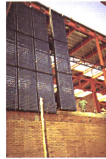
Fassadenintegrierte Photovoltaik-Anlage (53 kWp) des Mataró Bibliotheksgebäudes, Barcelona, Spanien. Quelle: tfm, Spanien.
