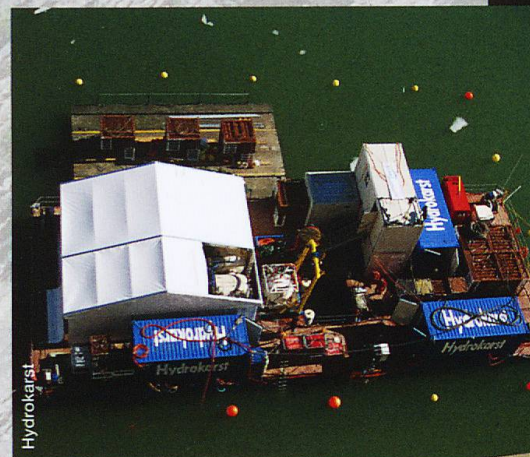
Abb. 2 Installationsplattform für Sättigungstauchen (Beispielbild)
