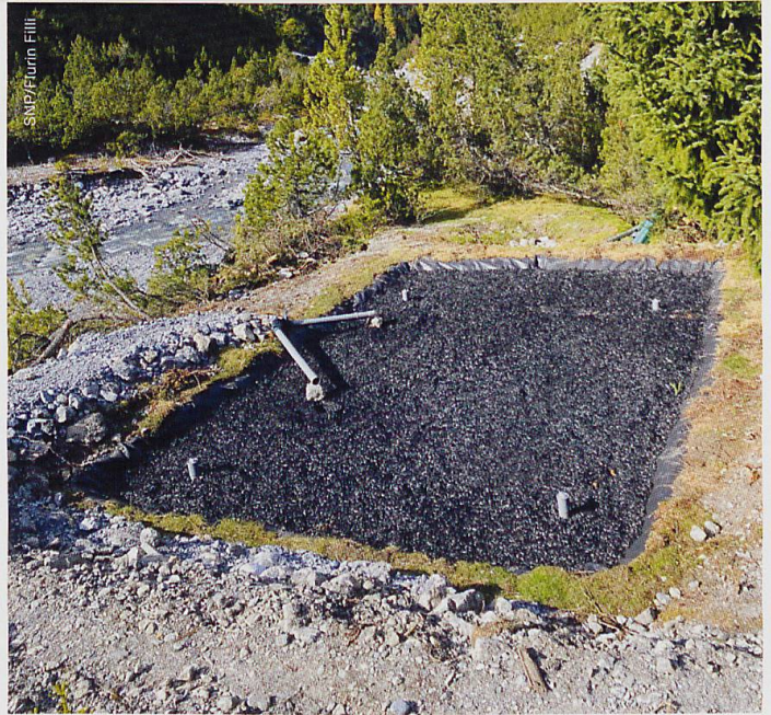
Die neue biologische Kläranlage verfügt neben Wurmkompost über ein zusätzliches Pflanzenbecken, das 2022 bepflanzt wird und für die abschliessende Klärung sorgt.
