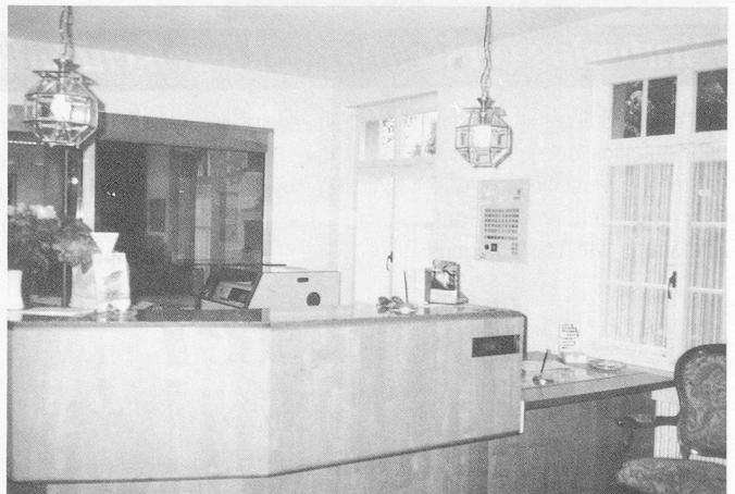
Blick in die Rezeption mit der Feuermeldeanlage an der Wand.
