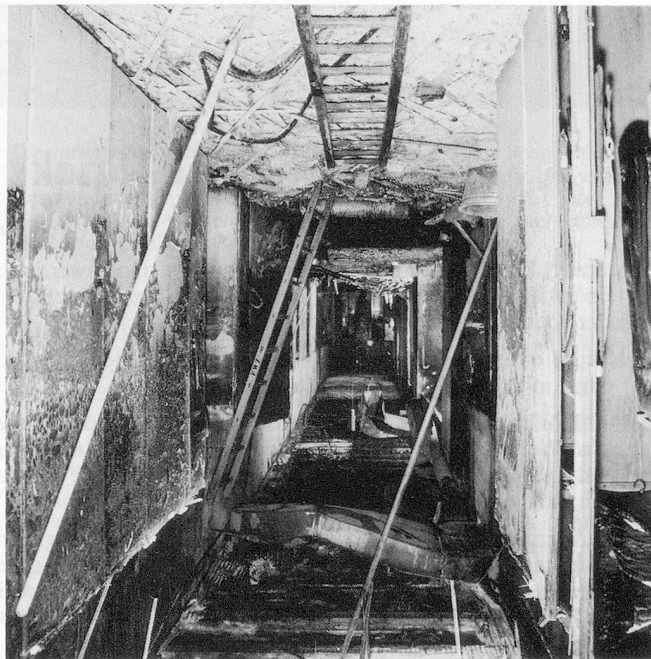
Rettungs- und Fluchtwege sind durch Brandschäden oft schwer- oder unpassierbar.
