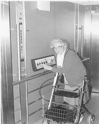
Beispiel einer gelungenen Liftsanierung in einem Blinden- und Sehbehindertenheim in Zürich: Zusätzliches Behindertentableau, doppelte Stockwerkerkennung (oben im Bild der Lautsprecher), erhabene Taster mit eingravierten Normalbuchstaben und Braille-Schrift, gut gekennzeichnetes Nottelefon.
