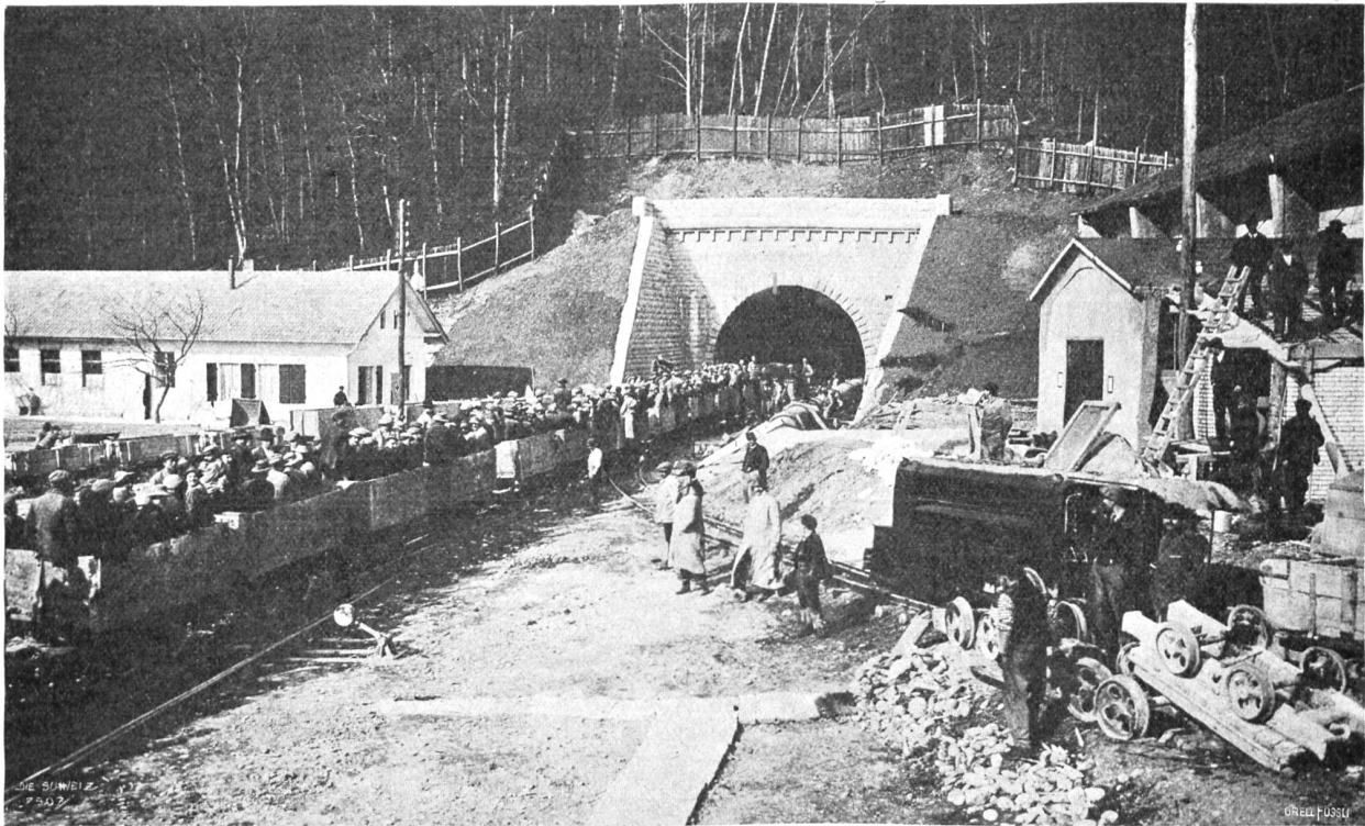
Vom Bau des neuen Hauenstein-Bafis-Tunnels. Das südliche Portal bei Olten mit einfahrendem Arbeiterzug. Phot. Anton Krenn, Zürich.
