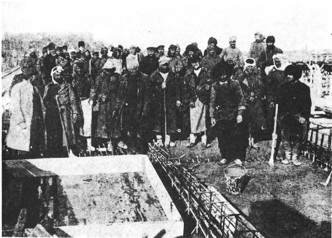
Fig. 23. — Pont routier sur la Kura à Gori dans le Caucase, vers 1905. A. Rotinoff et L. Daudon, ingénieurs. Vue du chantier.
