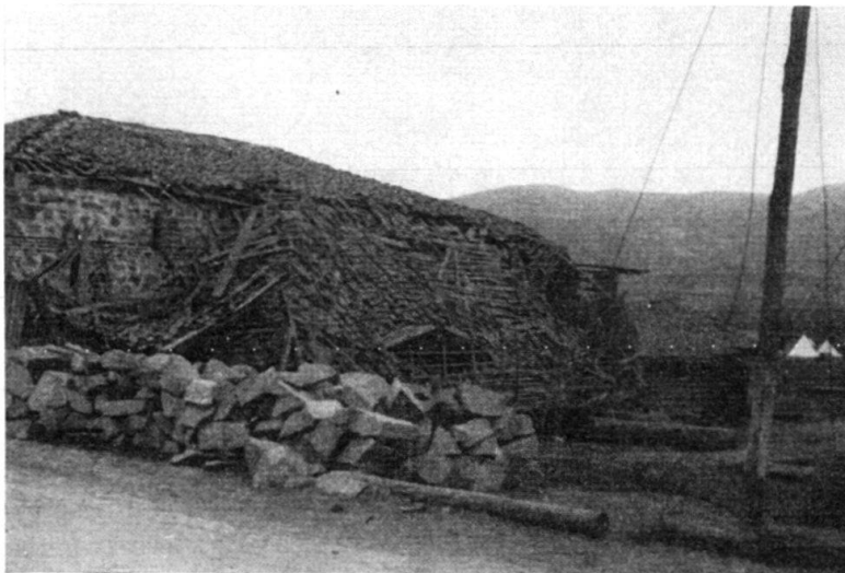
Fig. 8. Gemischte Konstruktion in Çan, seitwärts gestürzt.
