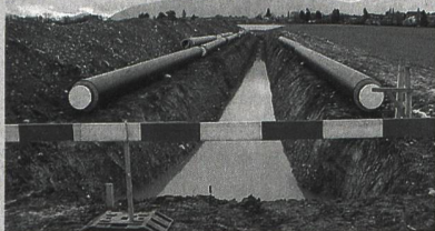
CADIOM: 24 km de canalisations
