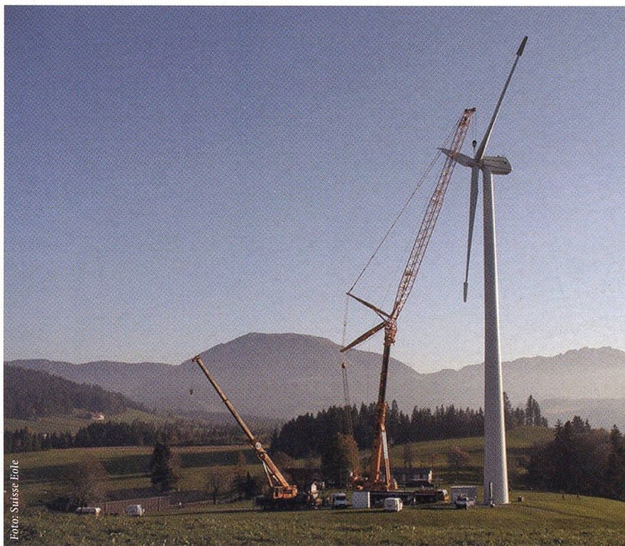
Die Zukunft mit erneuerbaren Energien ist möglich, sie muss nur noch gebaut werden: Hier im Entlebuch.
