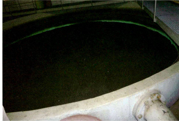
Schnellfilter I (Gebäude 1922).
