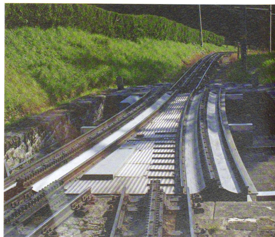
Heute noch betriebene Anlage der Pilatusbahn. Je nachdem, welcher Strang der Ausweichstelle benützt werden muss, wird das passende Gleisstück eingefahren.
