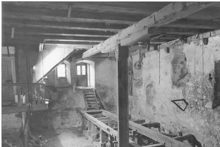
Bild 13: Blick auf Mahlstuhl während es Umbaues von 1968. Links ist noch die ehemalige „Kommandobrücke“ des Müllers zu sehen, im Hintergrund der Ausgang nach Westen.
