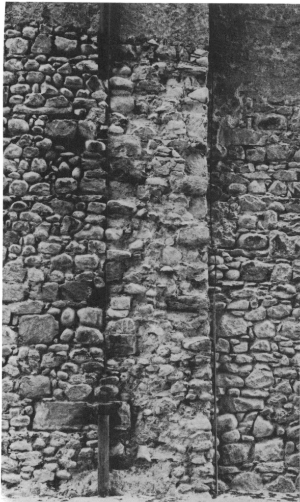
Figure 38. Arrachement de la façade de l'église du xv e siècle, côté nord.
