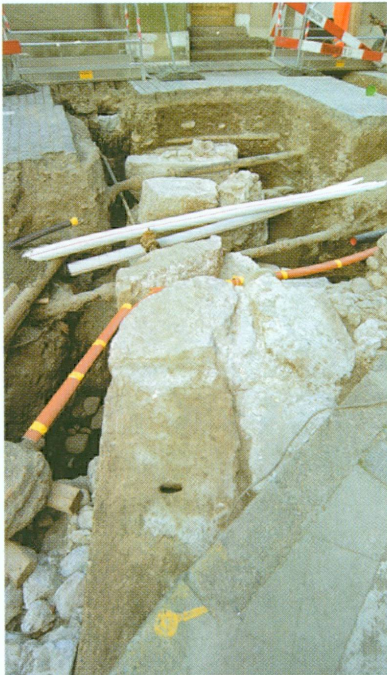
2. Rue Farel | L'enceinte du Bas-Empire apparaît directement sous le bitume lors des travaux de canalisations.
