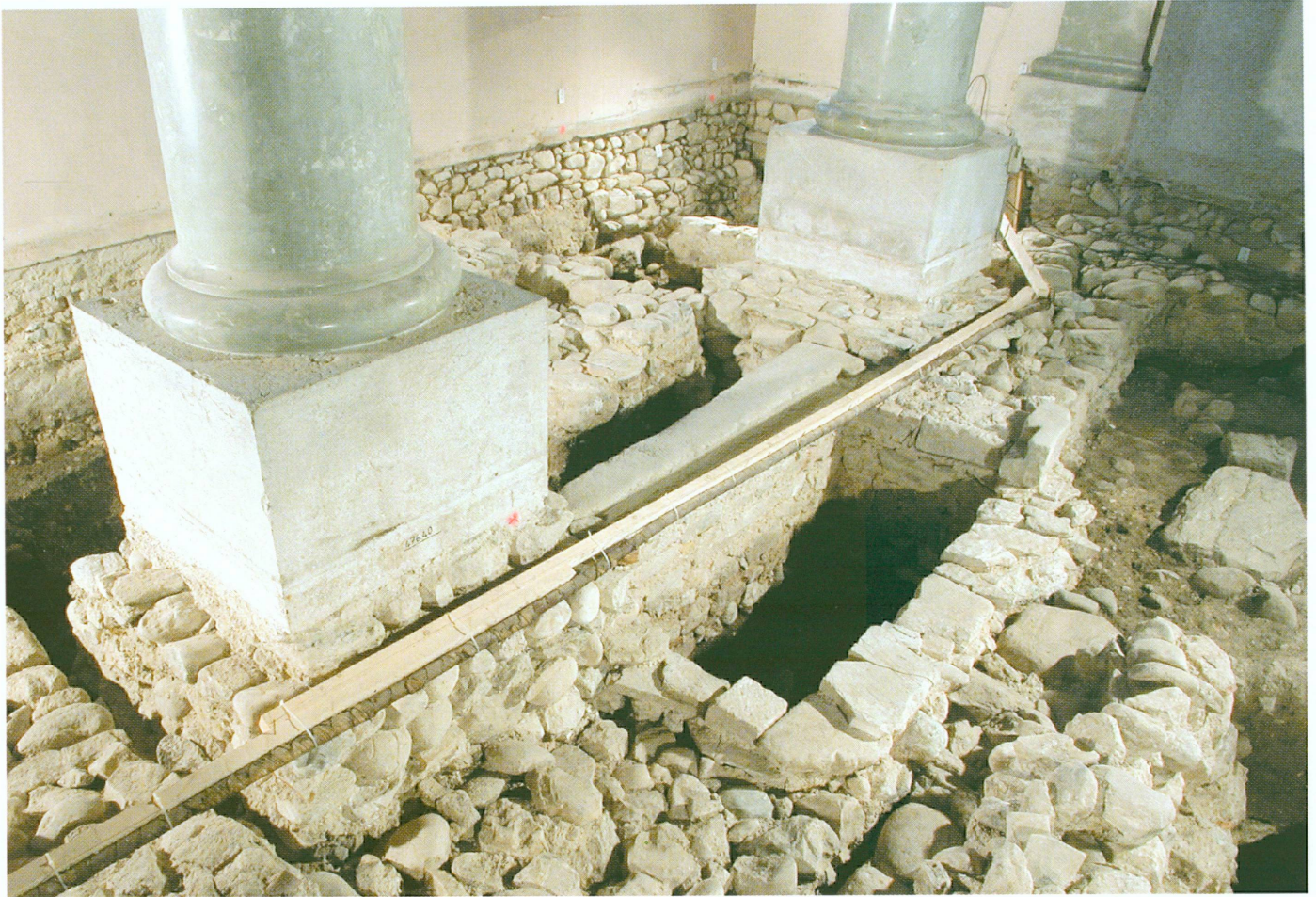
42. Compsières, église Saint-Sylvestre | Caveau maçonné (fig. 29, lettre T) où fut enseveli le commandeur Jacques (I er ) de Cordon d'Évieu, mort à Compsières le 11 mars 1646
