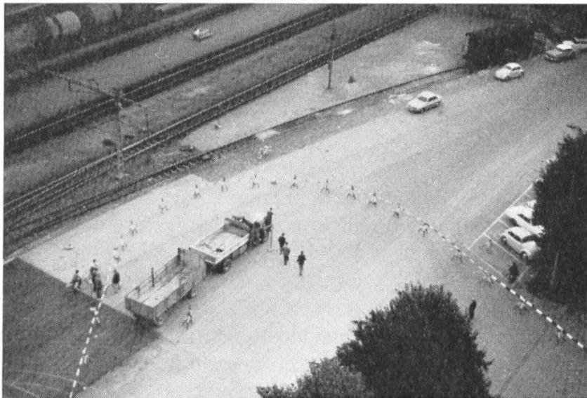
Abb. 8: Abgesteckter und markierter Fahrbahnrand. Mit Hilfe der vorgängig durch Kartontafeln bezeichneten Bogenanfänge und Tangentenpunkte konnte diese Markierung von 4 Mann in wenigen Minuten umgestellt werden.
