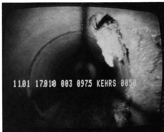
Abb. 4 Kalkausscheidung bei Rohreinmündung.
