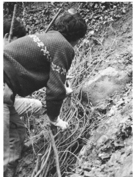
Abb. 4 Lebender Flechtzaun: In den vorbereiteten Gräben wurden Weidenpfähle gerammt. Elastische Weidenzweige werden dazwischengeflochten und mit dem folgenden Aushub eingedeckt.
