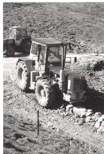
Abb. 2: In ein bis zwei Durchgängen bereitet der traktorgezogene Kirpy das Koffermaterial aus dem Vortrieb an Ort auf. (Foto: F. Walder, Kt. Meliorationsamt SZ).
