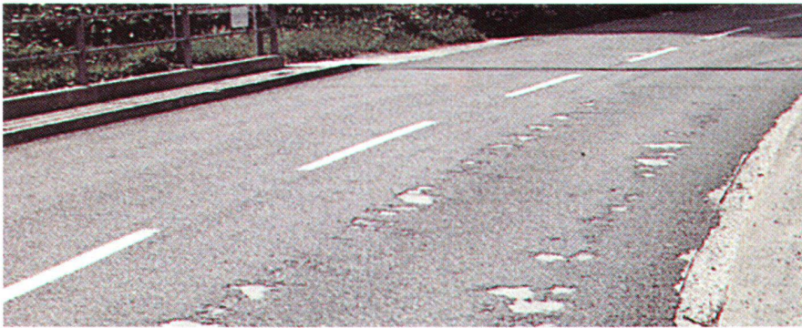
Abb. 5b: Schadenbild bei Strassen und Wegen.
