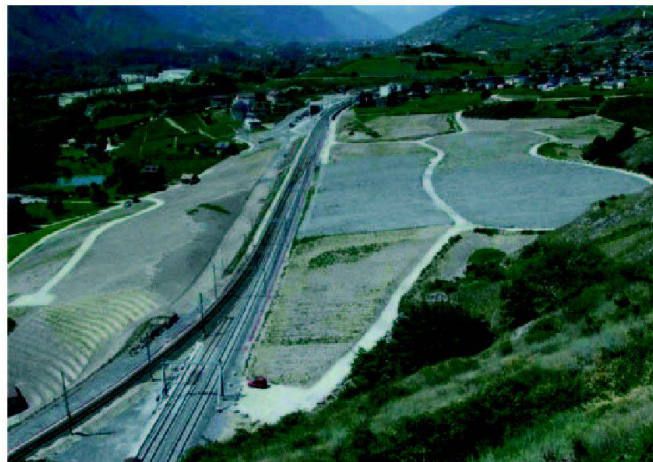
Fig. 6: Les matériaux d'excavation des tunnel CFF servent d'assise aux nouvelles voies pour la traversée d'une combe viticole.
