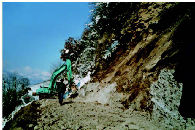
Fig. 4: Accès intermédiaire et purge des falaises.
