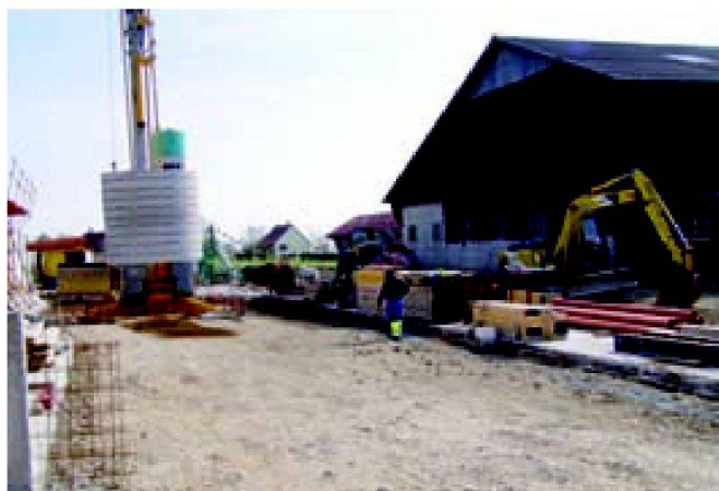
Fig. 1: Etape de construction des fondations et radier de l'annexe du rural existant (Source: Service du développement territorial Vaud).
