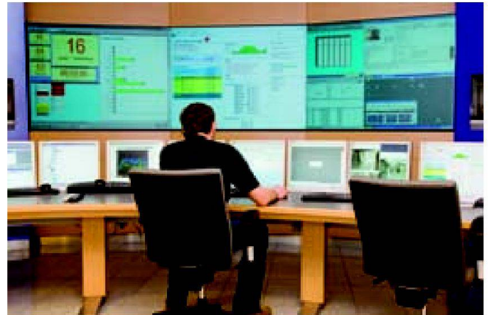
Schnelle Auskunft: Mit einem Klick erkennen Mitarbeiter bei LIWEST, ob ein Hausanschluss von einer Störung betroffen ist.
