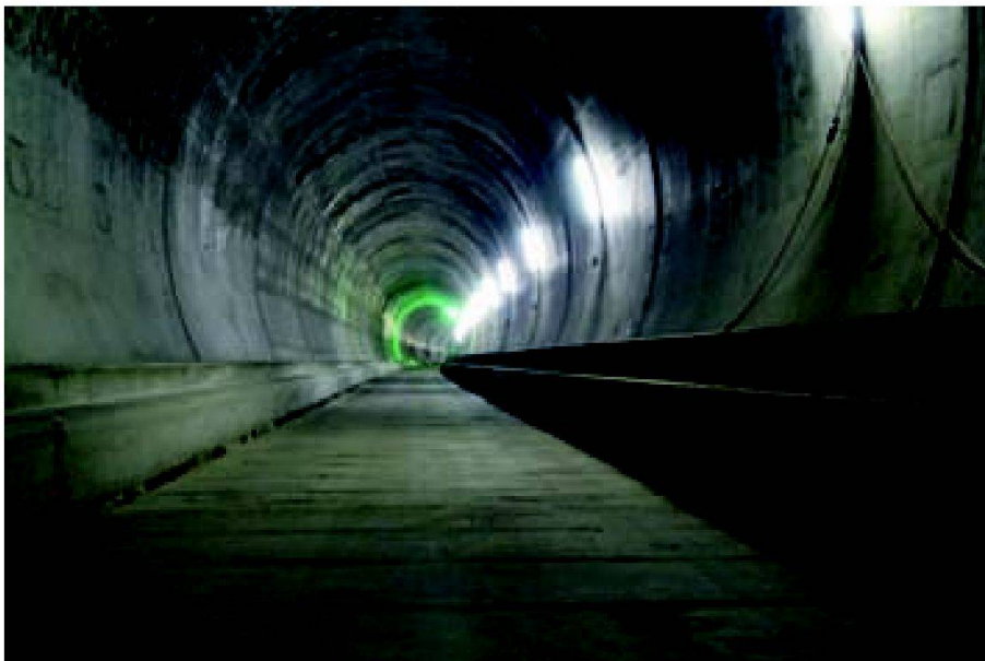
Abb. 4: Im Abschnitt Bodio hat in der fertigen Weströhre im Mai 2010 der Einbau der Bahntechnik begonnen.
