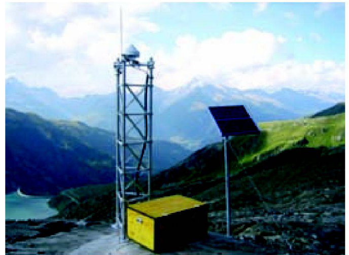
Abb. 6: GPS-Anlage oberhalb des GBT-Trassees bei Mauer Nalps.
