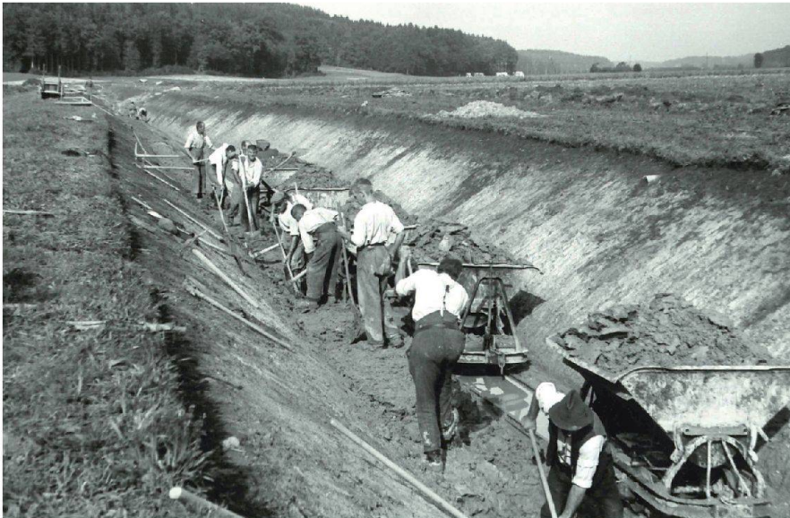
Abb. 6: Kanalbau Altache, Bleienbach, 1943. Aushub ohne Bagger durch Abgraben von Hand und Schaufelwurf direkt in die Kippwagen.
