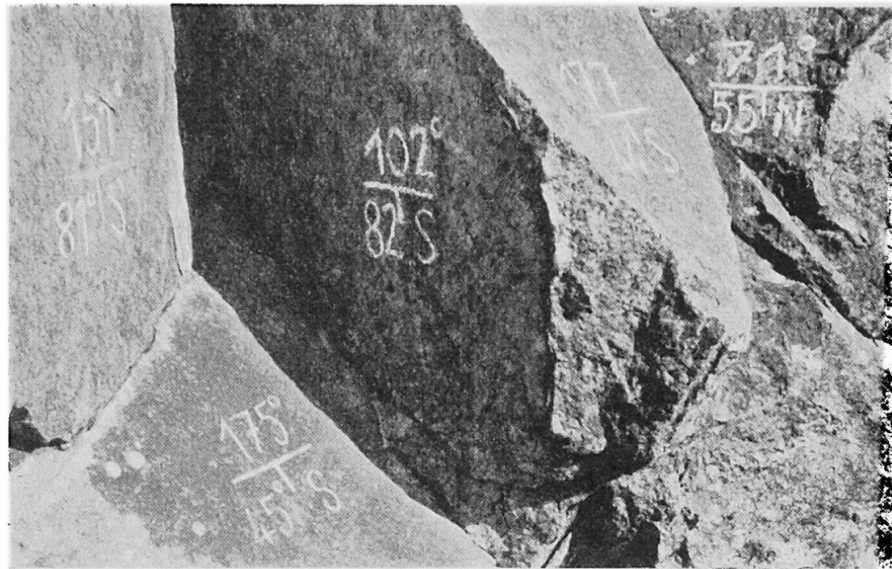
Abb. 3: Kluftflächen einer Sprengstelle an der Grimselstraße. Streichen und Fallen der Flächen wurden mit Kreide aufgezeichnet.
