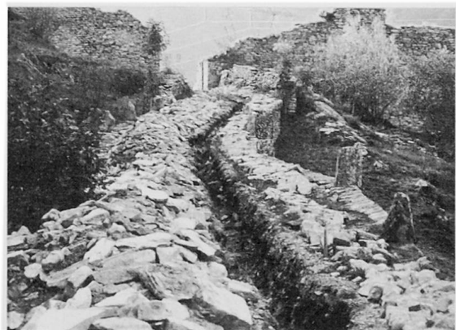
Abb. 8 Promontogno, Sperre Castelmur (GR): Die Plästerung eines bedeutenden historischen Weges wird zur Verlegung eines Leitungskabels aufgebrochen. Standort: 763 500/134 200/900 m; Bildmitte: Az: 4600 A o/oo; LK: 1276.
