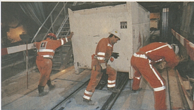
Die Förderwagen werden über eine vollautomatische Beschickungsanlage dem Korb zugeführt. Für Sondertransporte kann jedoch auch eine Handsteuerung erfolgen.
