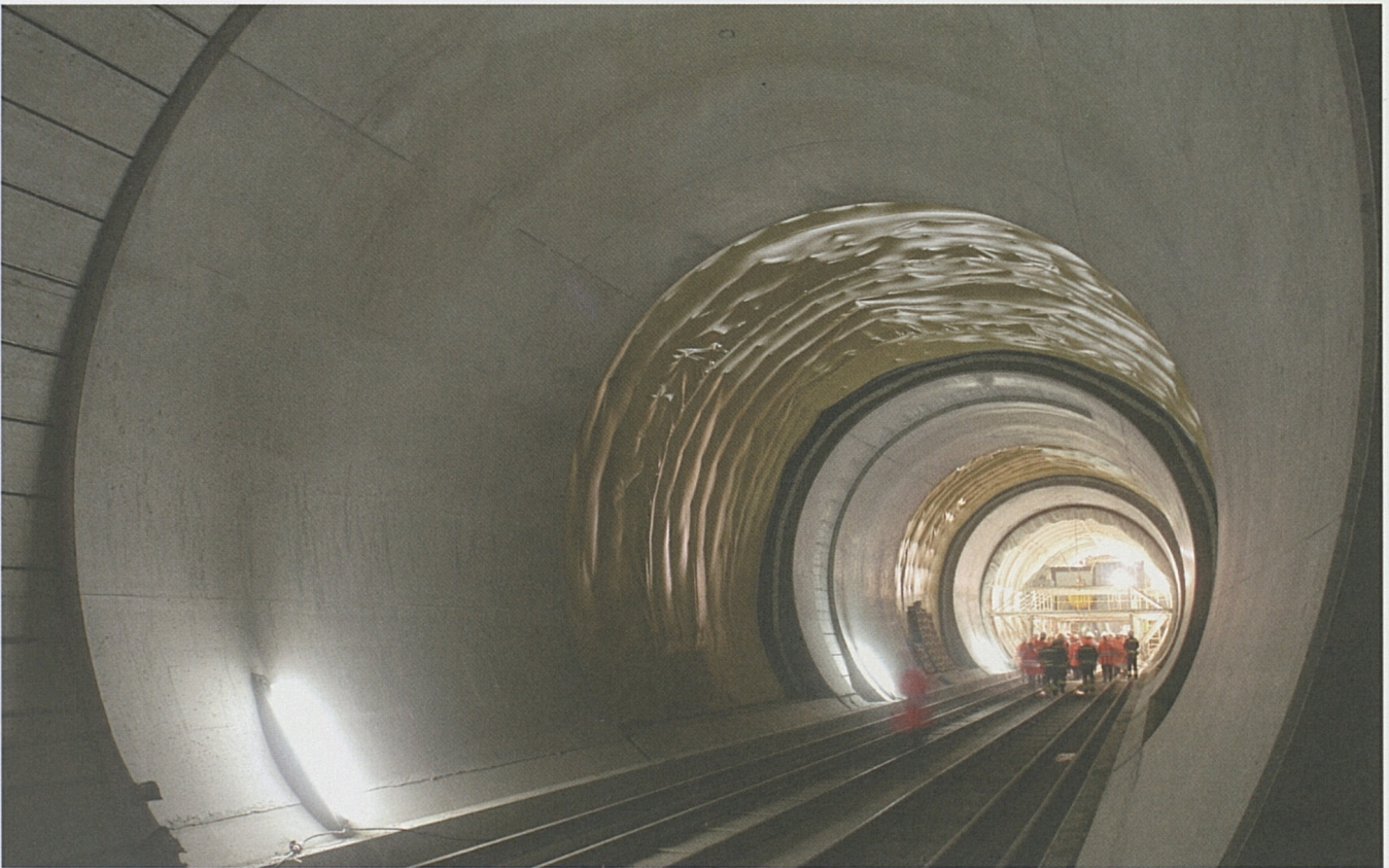
Die ersten Gewölbebetonetappen in der Multifunktionsstelle Sedrun, in den Lücken die Abdichtung gegen Bergwasser.
