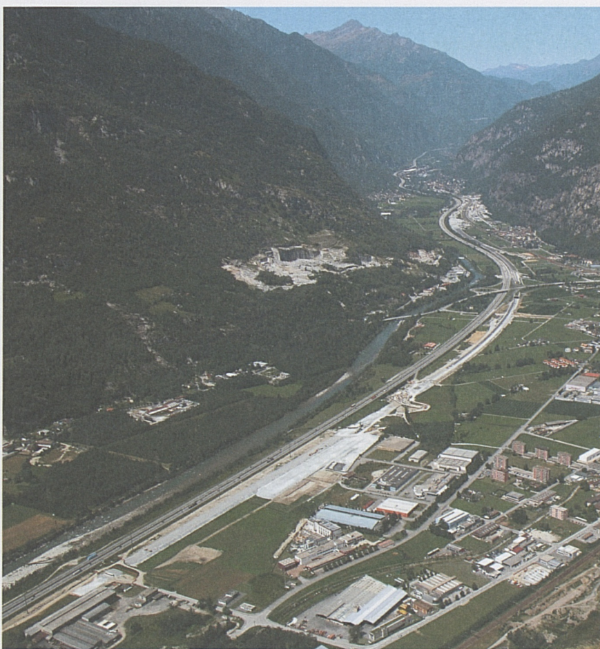
Foto sopra: panoramica dei lavori a cielo aperto nella zona di Biasca.
