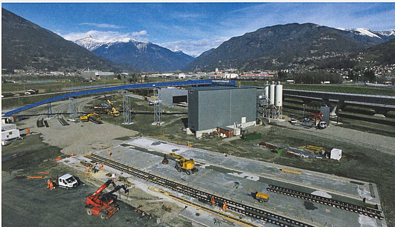
Camorino, piazzale d'installazione della tecnica ferroviaria
