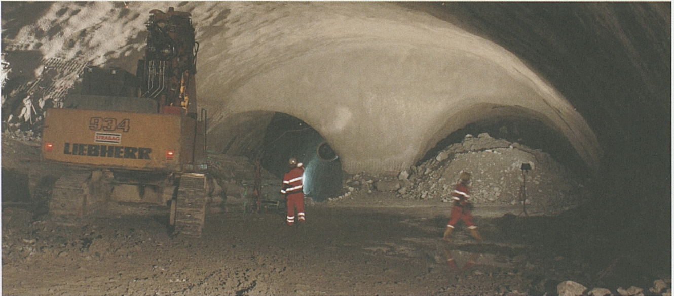
Das im Bau befindliche Verzweigungsbauwerk in der Oströhre bei Erstfeld. Links die Einspurröhre, rechts die abzweigende Röhre.
