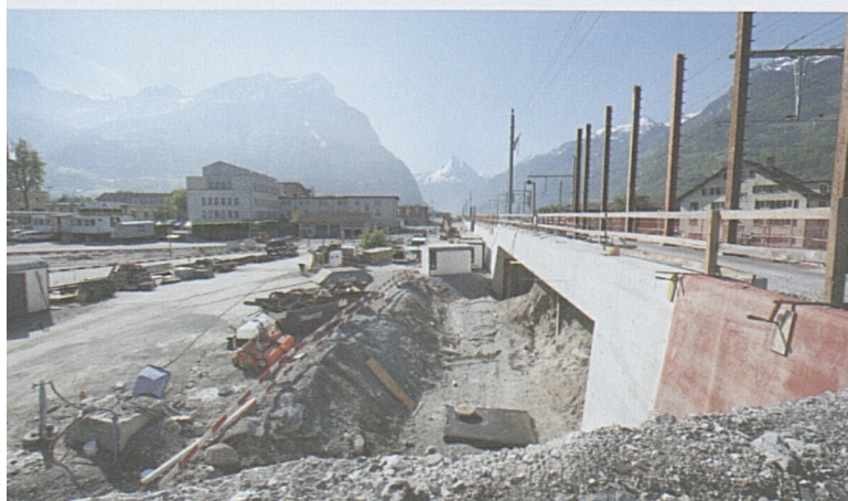
Neue Zufahrt nach Attinghausen: Die Unterführung Wysshus ist im Bau und wird voraussichtlich im Herbst 2012 eröffnet.
