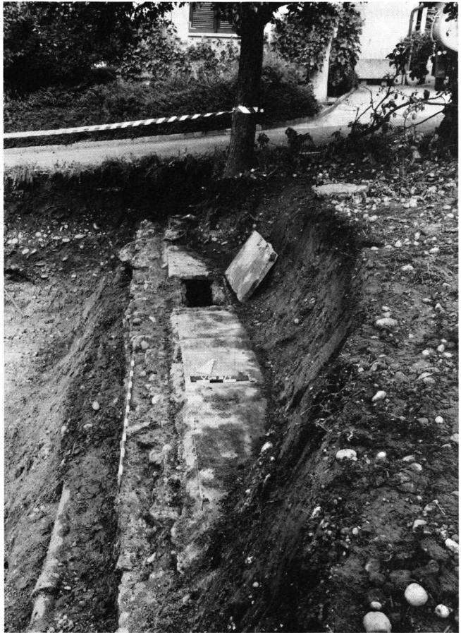
Abb. 6: Windisch-Oberburg 1995 (V.95.9): Blick in Fliessrichtung, entlang dem östlichen Baugrubenrand aus Süden auf den freigelegten, funktionstüchtigen römischen Frischwasserkanal, der hier 1934/35 nach einer Revision mit Betonplatten gedeckt wurde; links daneben eine Druckwasserleitung von 1871 mit Gusseisenröhren von Hausen nach Königsfelden.
