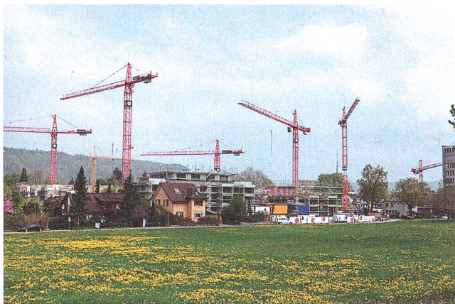
Abb. 4: Baukräne beherrschen seit Jahren das Ortsbild von Windisch. Blick vom Amphitheater im Frühjahr 2013 nach Nordosten.
