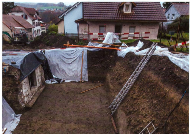
Abb. 28: Windisch-Ländestrasse 2017 (V.017.8). Blick von Norden auf die Baugrube nach Abriss von Haus Ländestrasse 2. Links der stehen gebliebene Gewölbekeller aus dem frühen 19. Jh. Die geputzten Baugrubenprofile zeigen geologische Schichten unter neuzeitlichen Planien.
