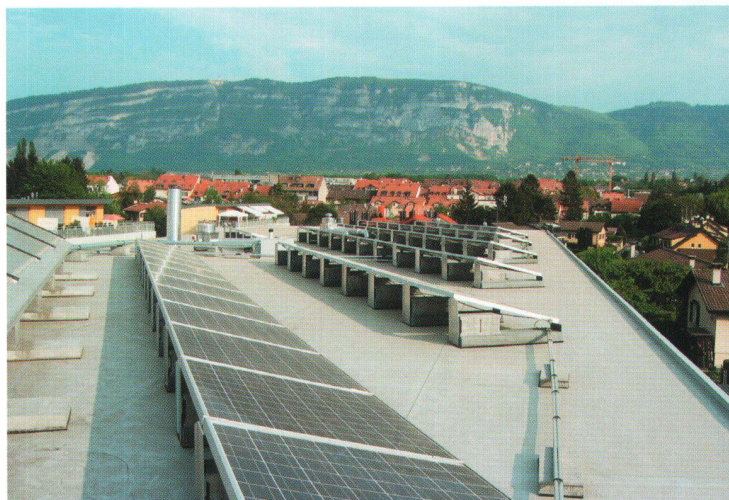
Les panneaux photovoltaïques installés sur la toiture. On devine à gauche les panneaux solaires thermiques qui assurent la totalité de la production d'eau chaude en ce mois d'avril 2007 très doux.
