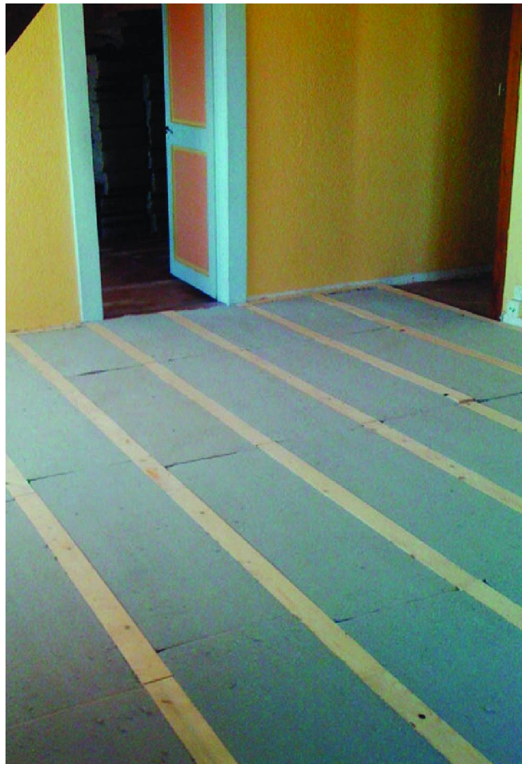
Isolation phonique d'un sol en ouate de cellulose en plaques (système Homatherm silentTop) avant la pose d'un plancher flottant.
