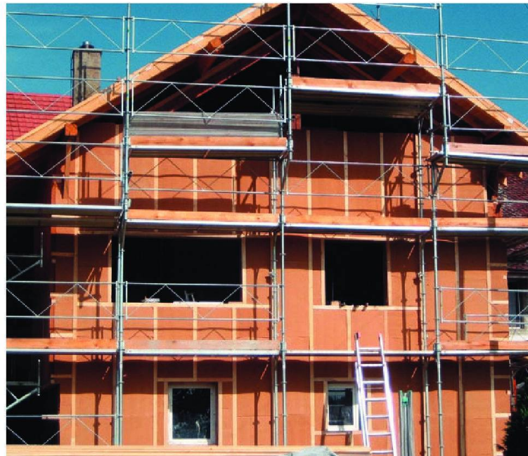
Isolation en fibres de bois avant la pose d'un coupe-vent et d'une façade ventilée.
