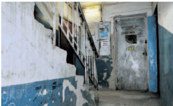
Un palier de l'immeuble rue de la Onzième Armée Rouge avant rénovations. © Ulrich Heyden
