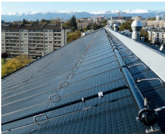
Capteurs solaires thermiques non-vitrés terminés sur Vidollet
