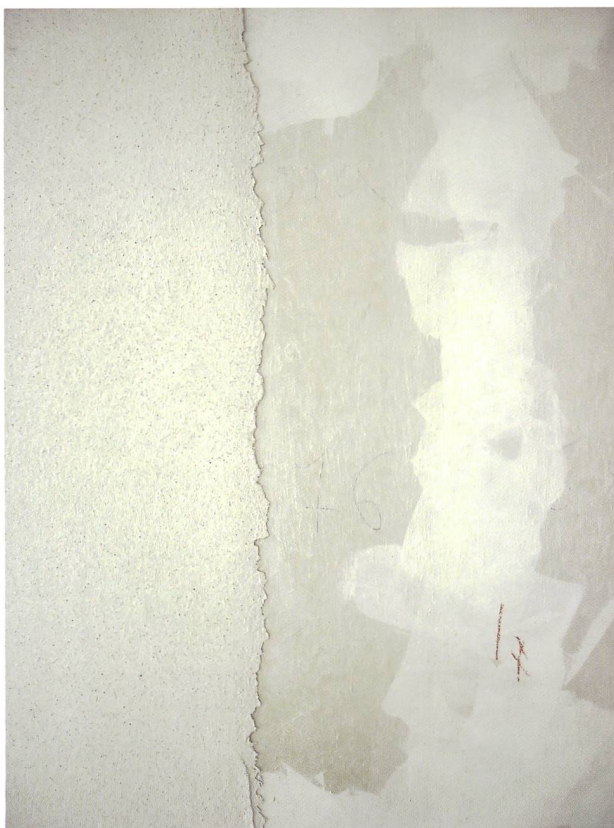
Sur la partie gauche: l'Argilus vient d'être appliqué; partie de droite: le mur est brut. © JLE
