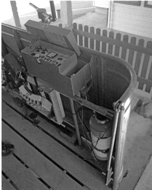
Links der Führerstand der Reichenbachfallbahn, rechts jener der Giessbachbahn, beide nach der Erneuerung der Wagensteuerung
