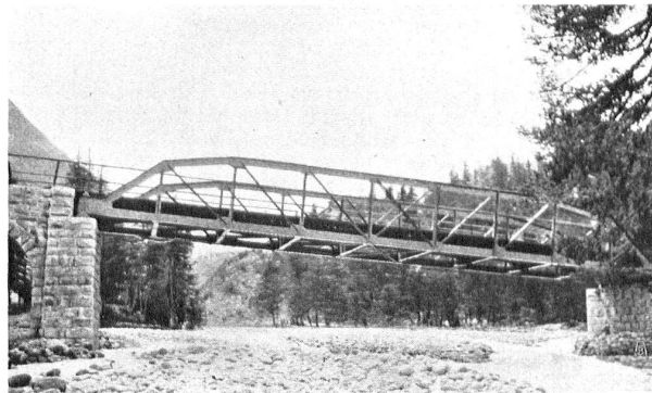
GEGENBEISPIEL: BRÜCKE DER BERNINABAHN beim Mortaratsch-Gletscher MAUVAIS EXEMPLE: UN PONT DU CHEMIN DE FER DE LA BERNINA, près du glacier de Mortaratsch
