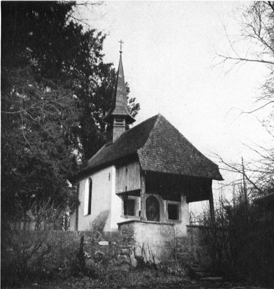
Heute sind die Grundmauern der Kapelle durch Feuchtigkeit schadhast geworden. Außerdem muß der Wald verjüngt und soll ein zweiter Rastplatz für die Jugend angelegt werden.
