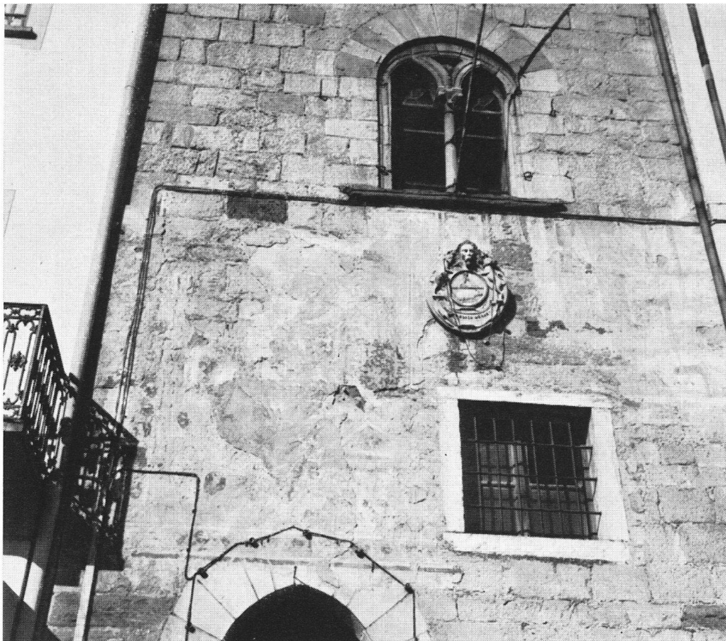
Teilansicht des mittelalterlichen Turmes des Rathauses aus der ersten Hälfte des 14. Jahrhunderts mit Resten wertvoller Fresken; unter dem prächtigen gotischen Fenster mit schönem Maßwerk das alte Gemeindewappen von Morcote. Ärgerlich ist die gedankenlos verlegte elektrische Leitung.
